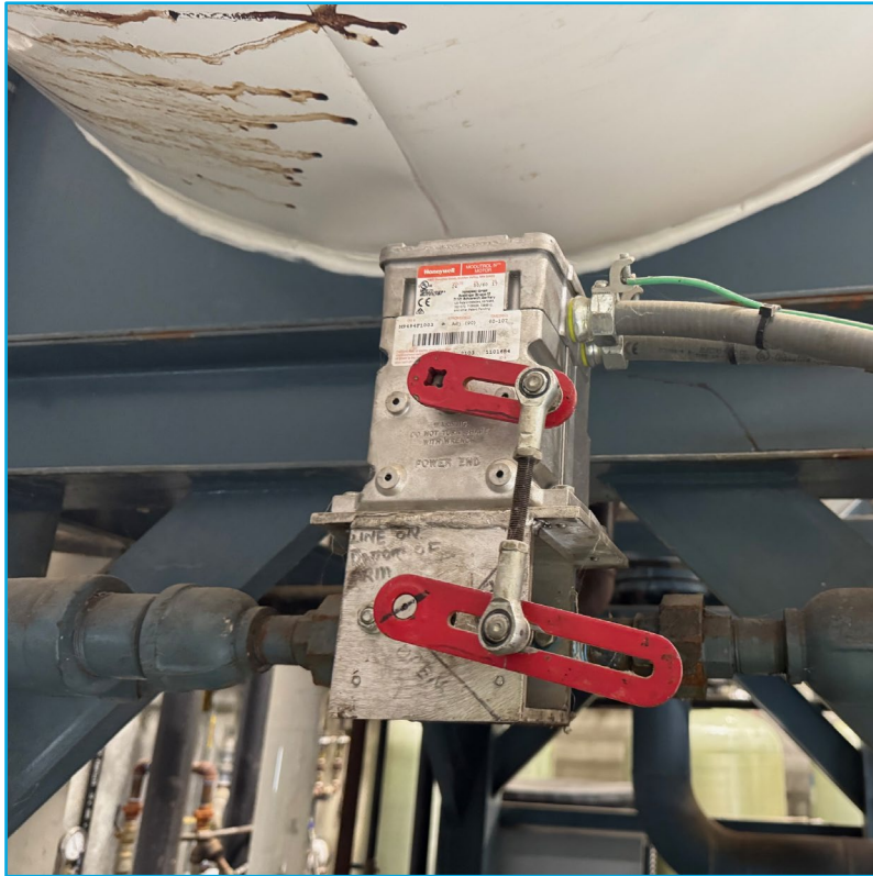
Válvula controladora del flujo de agua
