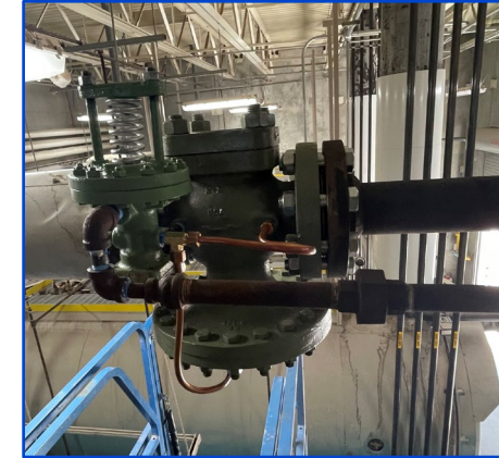
Válvula Reguladora de vapor
